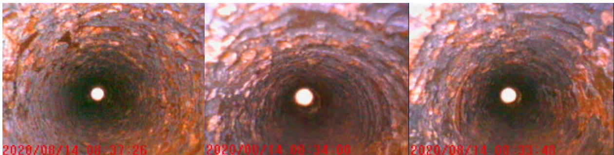
Figura 4. Fenomeni erosivi su tubi in Cu-Ni per la presenza di sabbia in sospensione nell'acqua di raffreddamento
