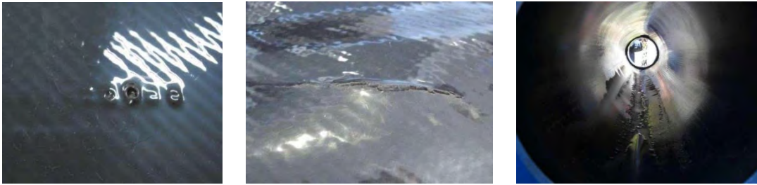
Figura 6. Difetti visibili, vesciche, crepe. Liner interno. (fonte: Liner integrity management - Primus Line 230041)
