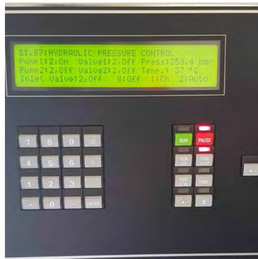
Figura 4. Display dei parametri operativi di funzionamento degli accumulatori idraulici e del circuito idraulico dell'aerogeneratore (pressione, temperatura, etc. etc.), posto alla base e nella navicella dell'aerogeneratore.
