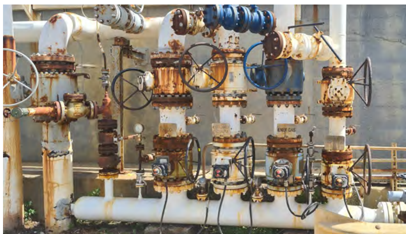
Figura 7. Collettore distribuzione ai gasdotti dal PO 68 per i Depositi Fiscali [11]
