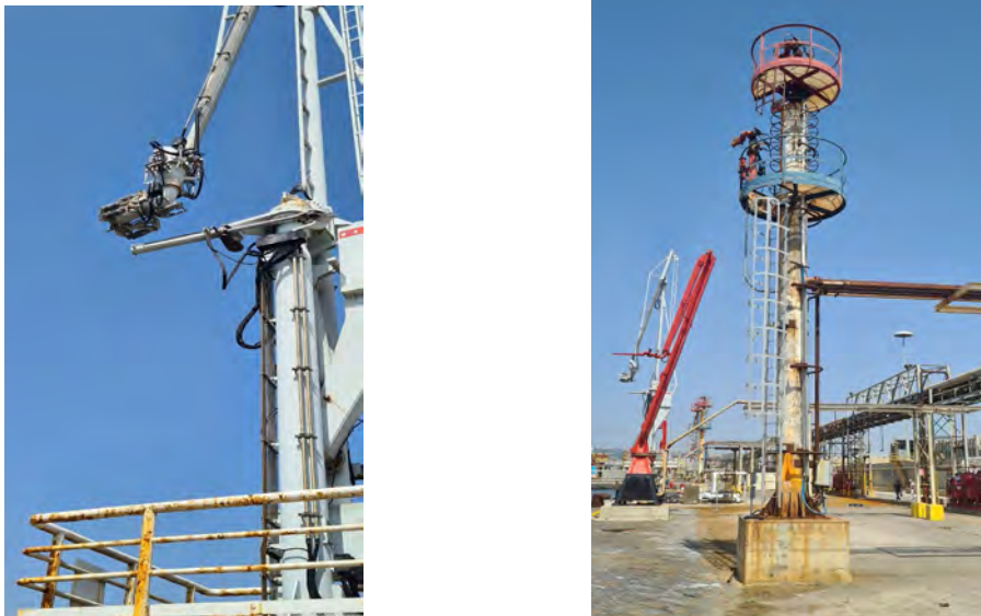
Figura 6. Strutture di carico e antincendio poste sul ciglio banchina della DP [11]
